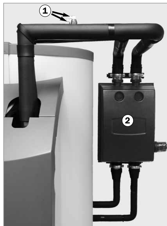
Anschluss an die Solestation
