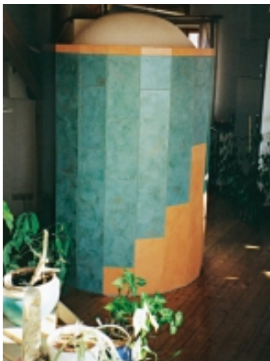
Bild 1: Kachelofen zur Ganzhausheizung mit eingebautem Wärmetauscher.
